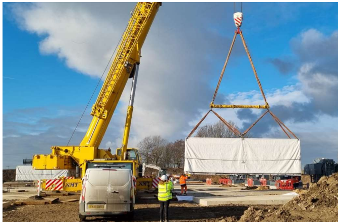
RUSHOLME 35MW / 70MWh TARGET COD: Q3 2023
